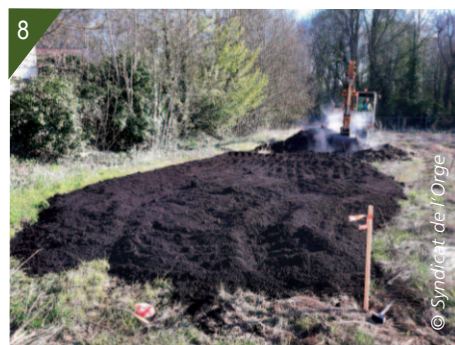
Épandage du compost de renouées. 7 - Compost étalé à même le sol. 8 - Compost intégré à la terre.
