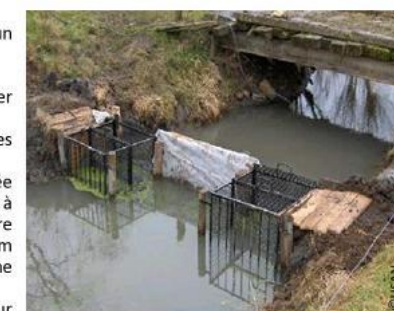
Barrage installé sur la rivière Vieille Lys
